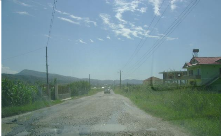
Figura 3-27 Segment i dëmtuar
