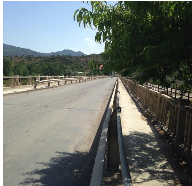
Figura 3-3 Parapetet dhe guard rail-et e dëmtuara
