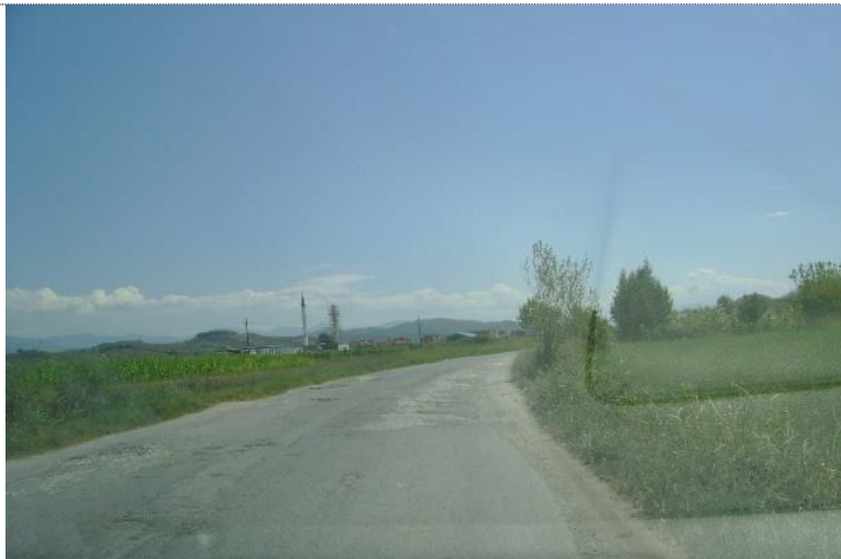
Figura 3-18 Segment i dëmtuar
