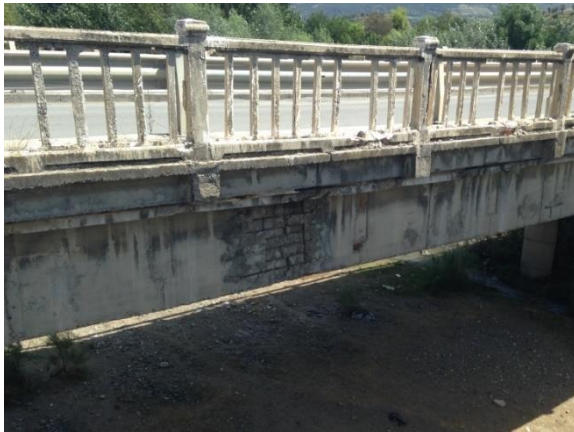
Figura 3-4 Çeliku i korrodur i trarëve
