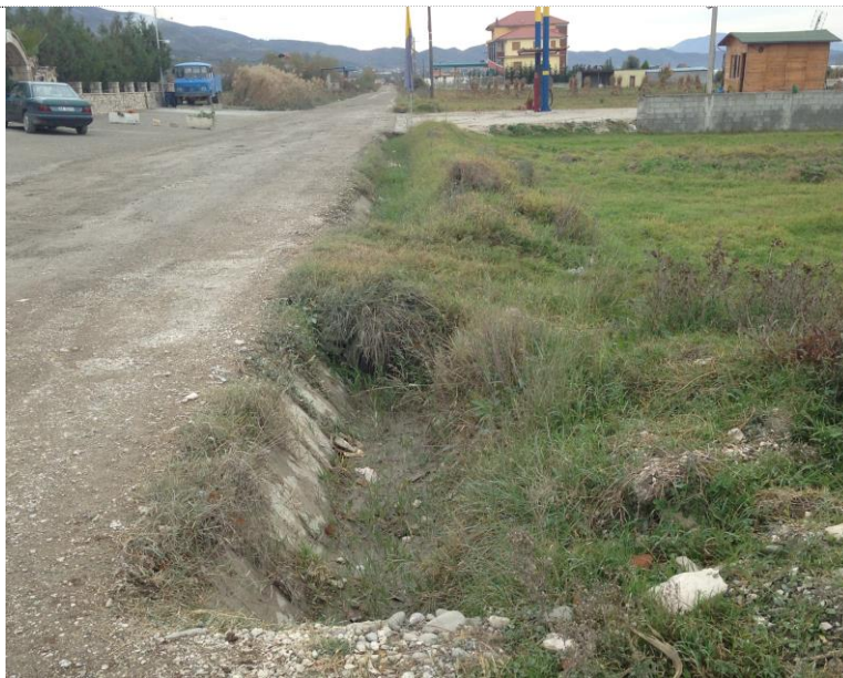
Figura 3-28 Segment i dëmtuar
