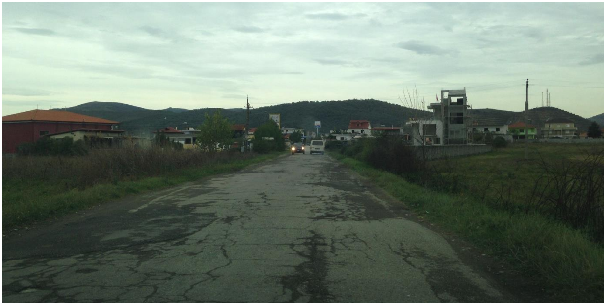
Figura 3-14 Shtresa të dëmtuara
