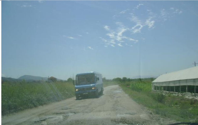
Figura 3-25 Segment i dëmtuar
