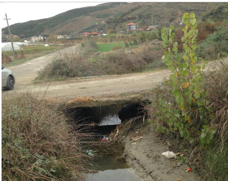
Figura 3-26 Segment i dëmtuar
